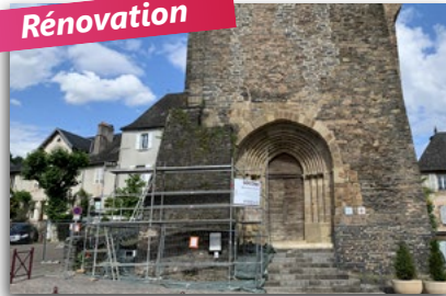
Epaulement nord-ouest de l'église Saint Jean-Baptiste Coût des travaux : 23 874€ Part communale : 9 948€
