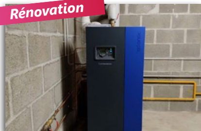
Changement de chaudière et mise aux normes de la chaufferie à l'école élémentaire Coût communal des travaux : 100 000€
