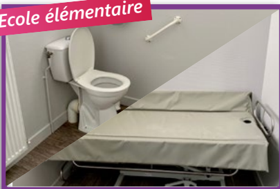
Création de sanitaires avec mise aux normes PMR et rénovation des WC Coût communal des travaux : 5 000€
