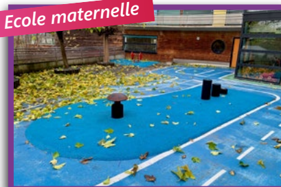
Pose d'un sol amortisseur autour des structures de jeux Coût communal des travaux : 4 000€
