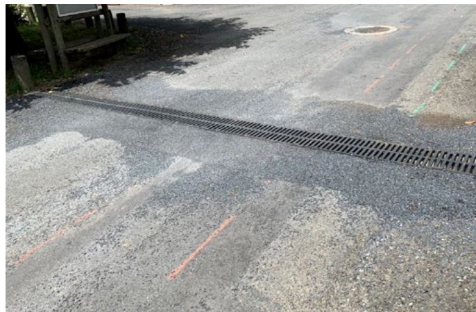
Gauch, reprise des eaux pluviales
